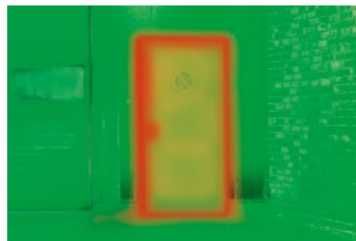
Sichtbarer Energieverlust ohne thermisch getrennte Tür
